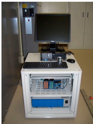
図2 直流電源装置の外観
