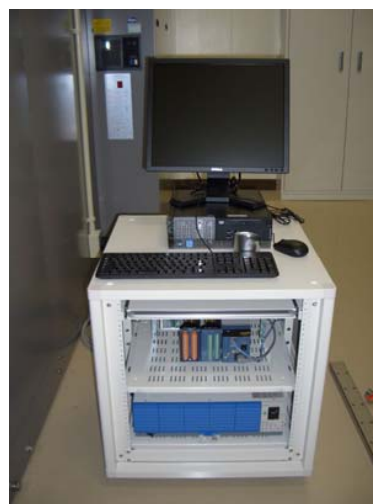
図 3 直流電源装置の外観
