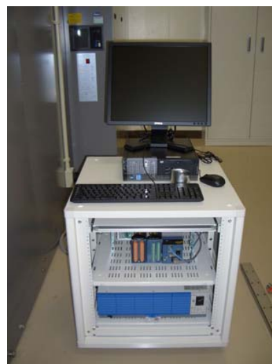
図 3 直流電源装置の外観
